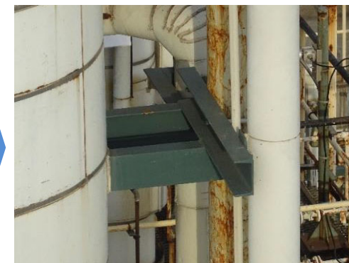
ドローン搭載カメラで撮影した死角となっていた配管の接触部
